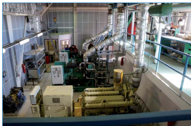
Машинный зал в здании электростанции-мастерских.
