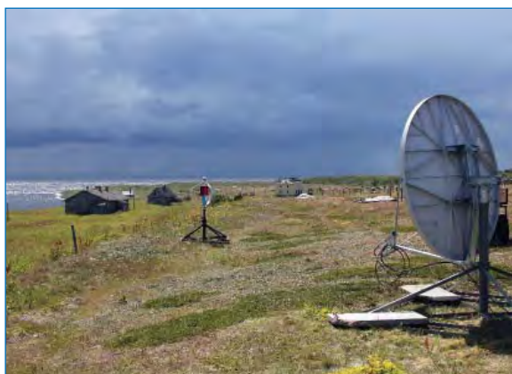
VSAT на ТДС Жижгин.
