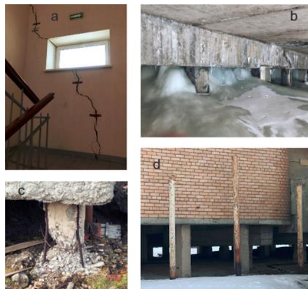
Рисунок 6.6 – Состояние инфраструктуры в Баренцбурге и Пирамиде: трещина в доме № 29, Баренцбург (а), наледь от протечки коммуникаций в доме № 31, Баренцбург (b), свая жилого здания РАЭ-Ш 2018 г., Баренцбург (с), керосиновые термостабилизаторы свайного фундамента 125-квартирного дома, Пирамида (d)
