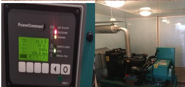
Рисунок 17.26 – Обсерватория ПГИ «Баренцбург» (здание рабочего павильона, санитарно-техническая платформа жизнедеятельности, система резервного энергоснабжения)
