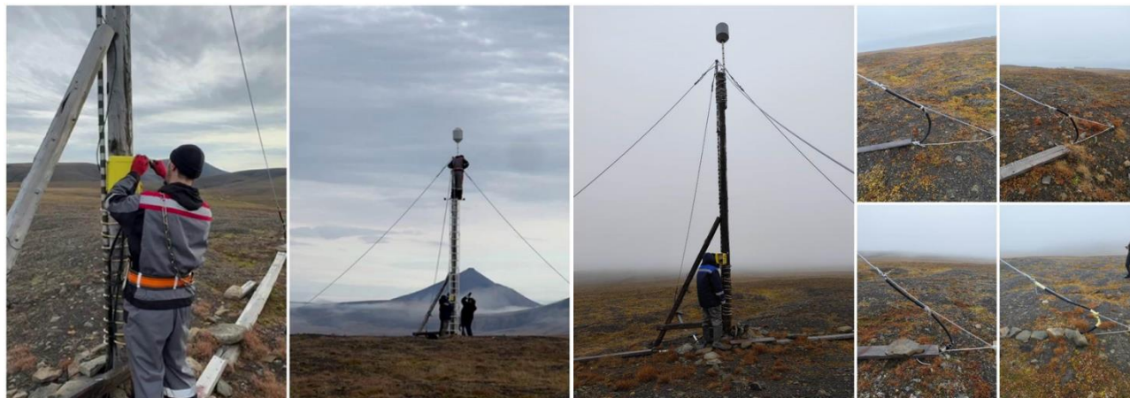
Рисунок 16.8 – ТО кабельной линии антенны Ez и точек её подключения и профилактика узлов крепления магнитных рамочных антенн
