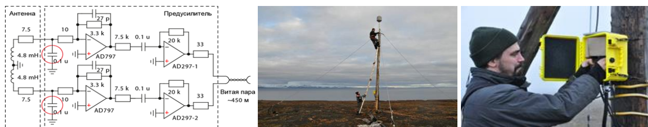
Рисунок 18.4 – (а) электрическая схема предусилителя компонент N \times N_0 , (б) замена оттяжек рамочной антенны, (в) замена блока предварительных усилителей
