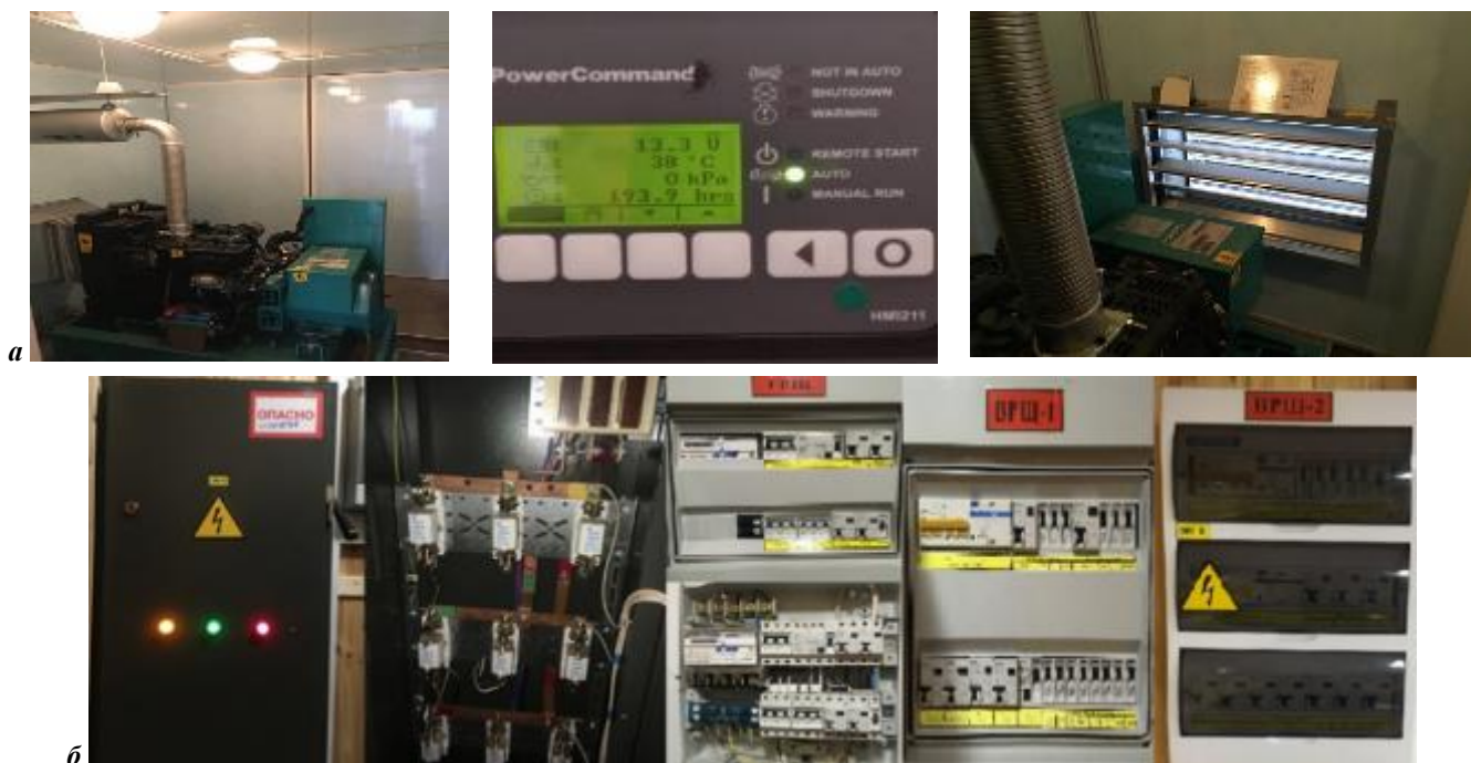
Рисунок 18.18 – (а) Система резервного энергоснабжения, обслуживание и проверка; (б) Внутренние электрические сети обсерватории ПГИ «Баренцбург»
